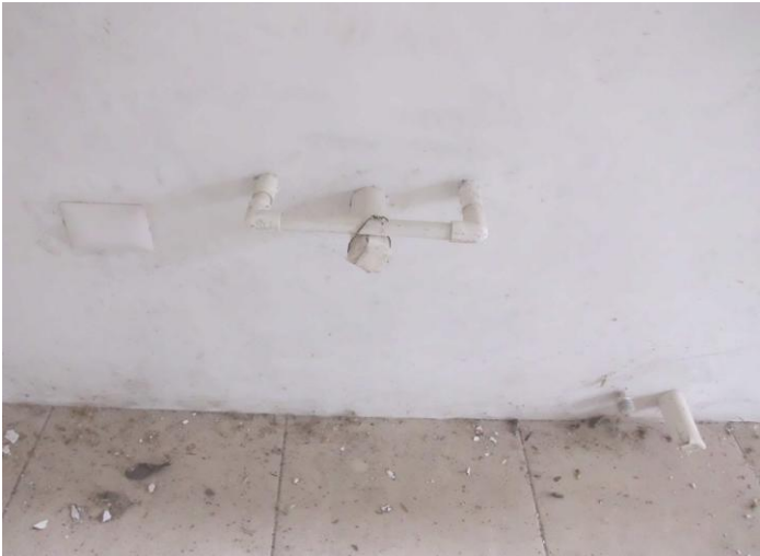
TUBERIA DE AGUA POTABLE DAÑADA
