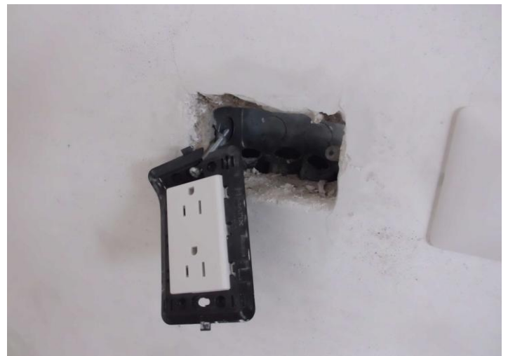
ARTEFACTOS ELECTRICOS DAÑADOS
