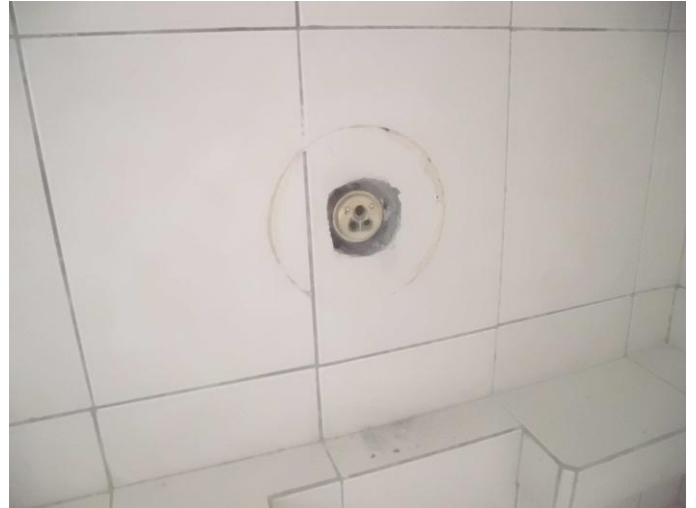
FALTA DE ARTEFACTOS DE GRIFERIA
